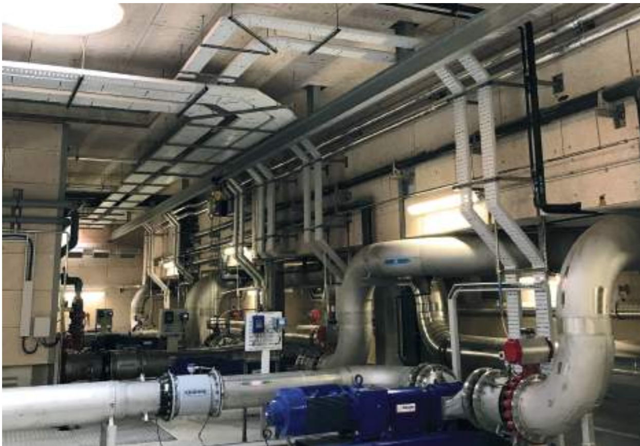
Traitement des eaux
