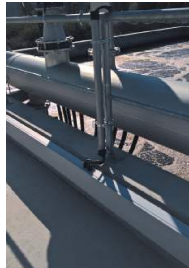
Traitement des eaux : Station d'épuration
