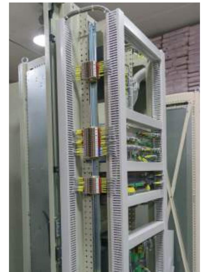
Production et distribution d'énergie électrique
