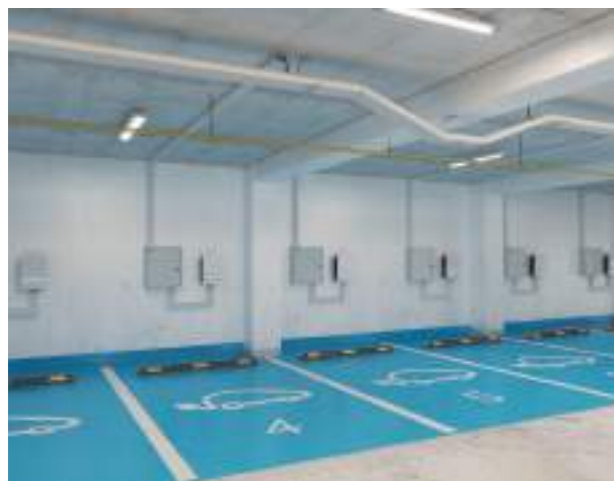
Infrastructures de Recharge pour vehicules Electriques
