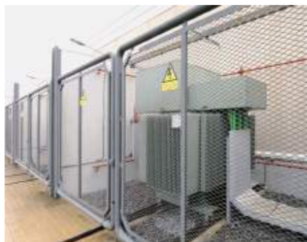
Reseaux de distribution électrique et les branchements
