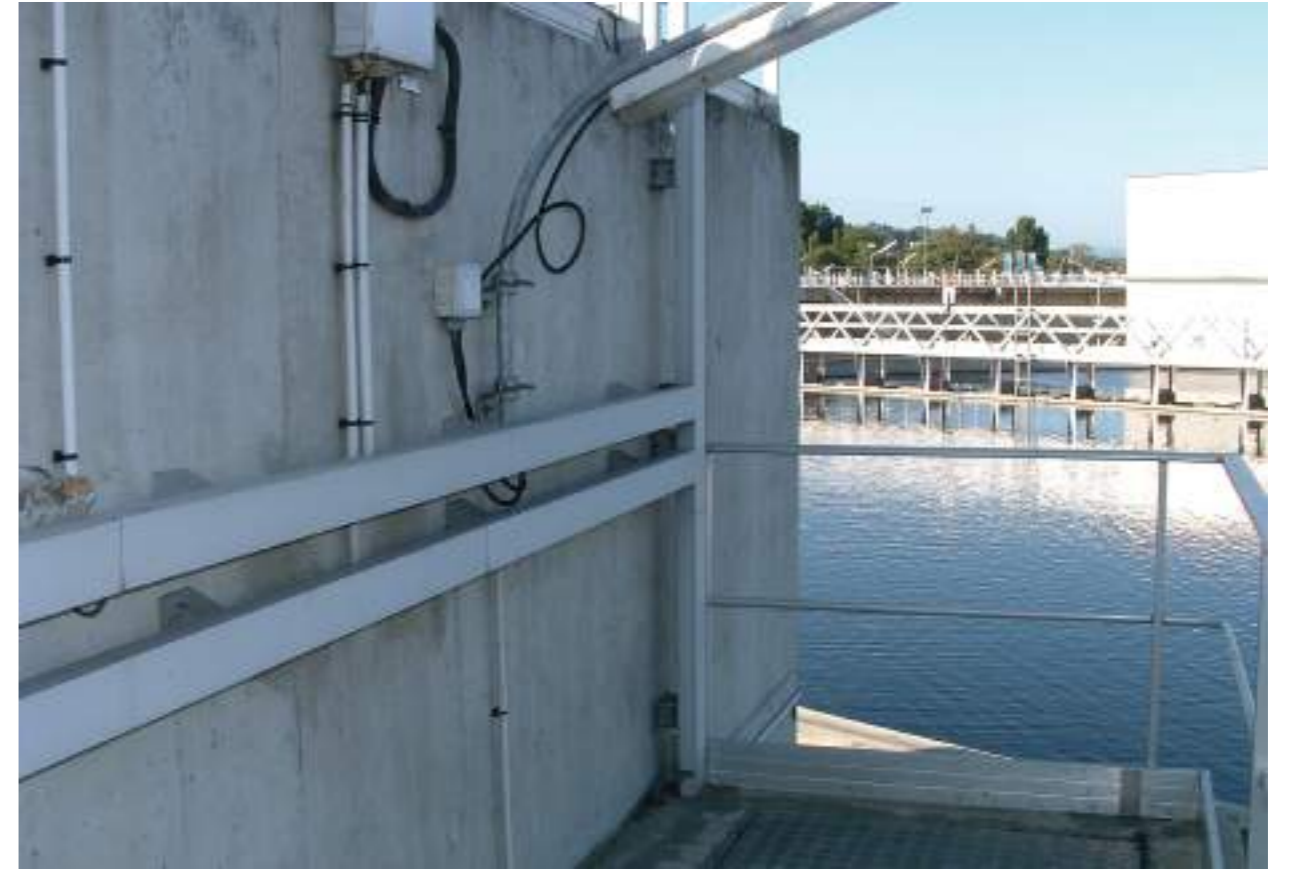
Traitement de l'eau
